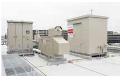
▲非常用発電設備 （平塚市消防署本署）
